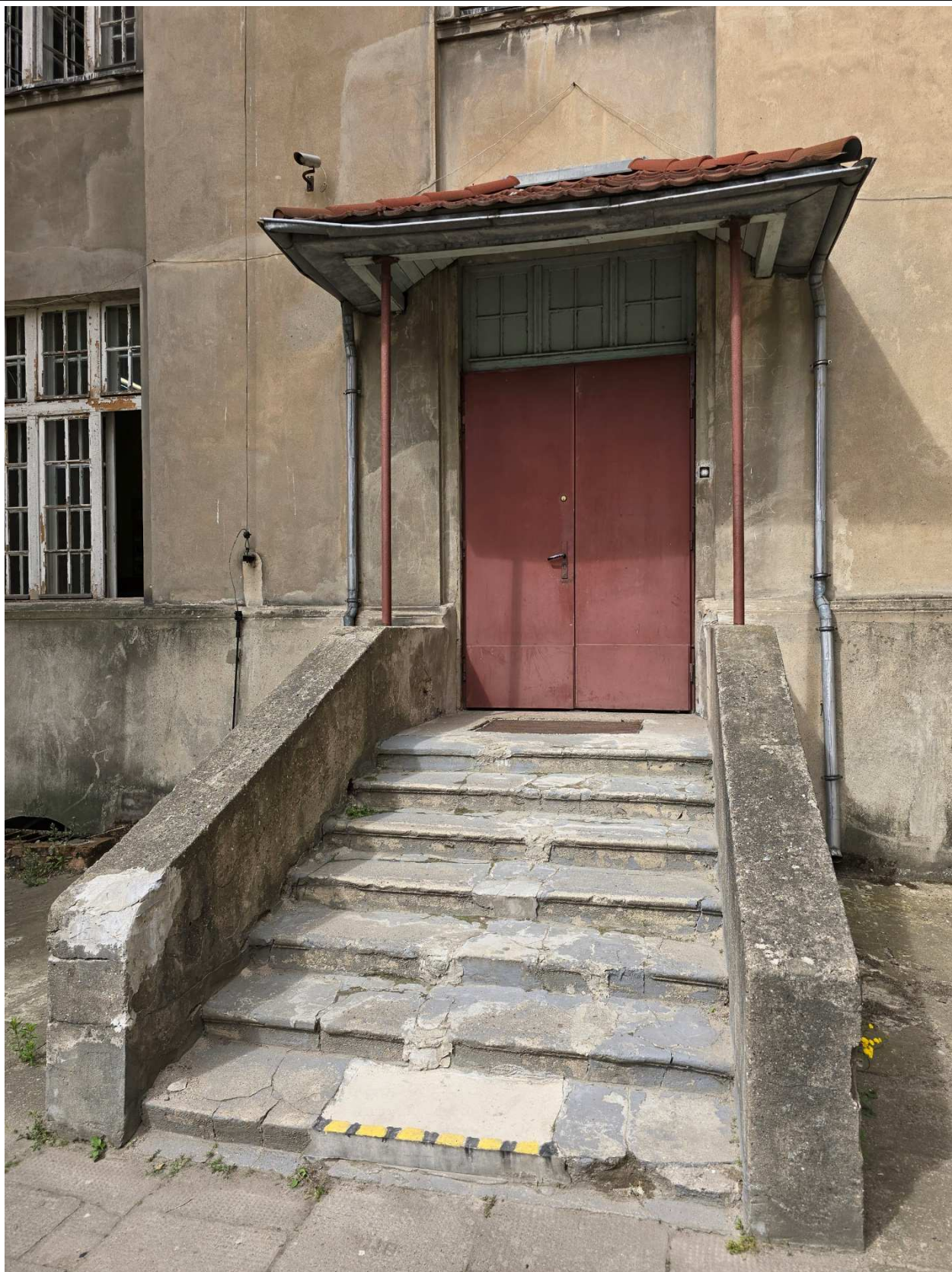
Fot. nr 4 – widok ogólny schodów nr D, liczne ubytki stopni, korozja cegły, spękania, zamurowane łuki w murkach bocznych itp.
