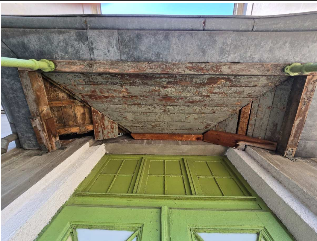
Fot. nr 11 i 12 – na fotografii nr 11 widać detal noska przy schodach nr D, który należy odtworzyć przy nowej okładzinie schodów, zaś na fotografii nr 12 widać stan podbitki zadaszenia nad schodami nr C
