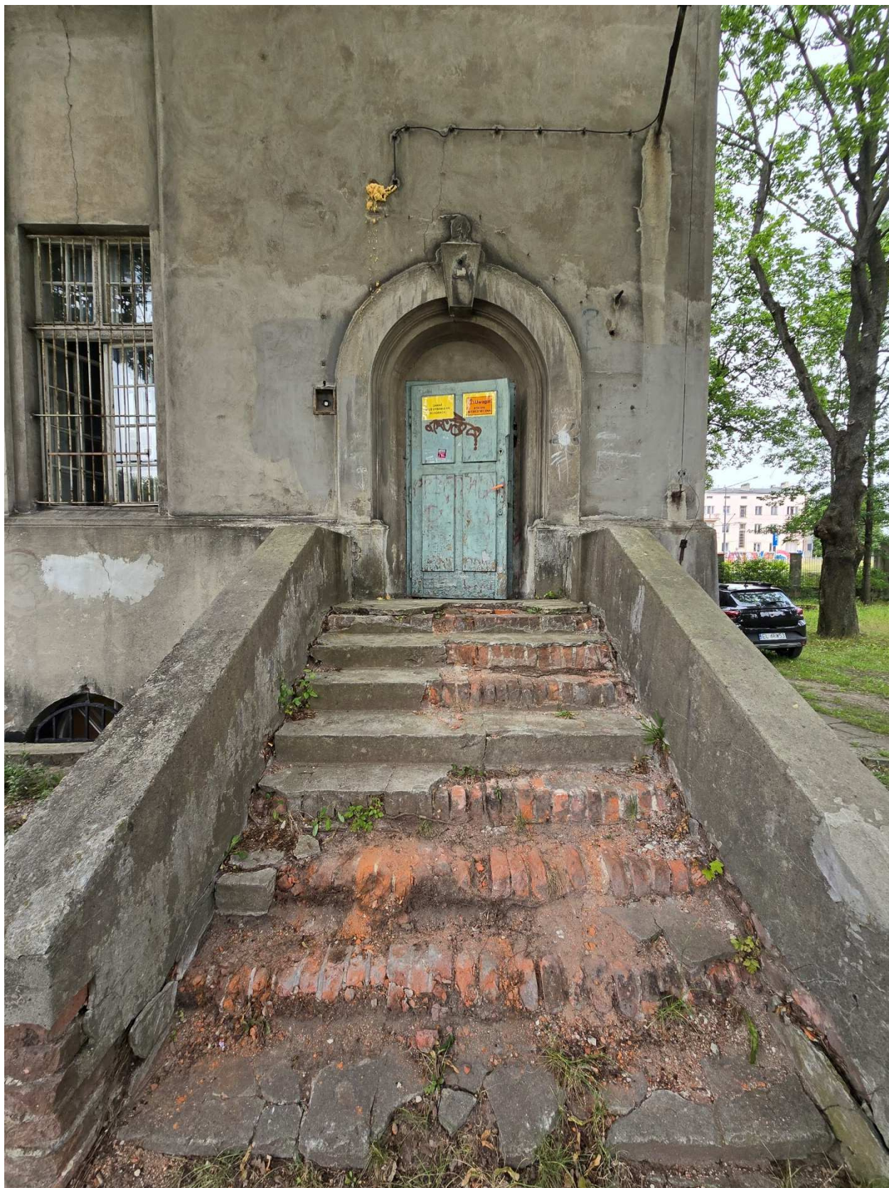
Fot. nr 1 – widok ogólny schodów nr A, liczne ubytki stopni, korozja cegły, spękania itp.
