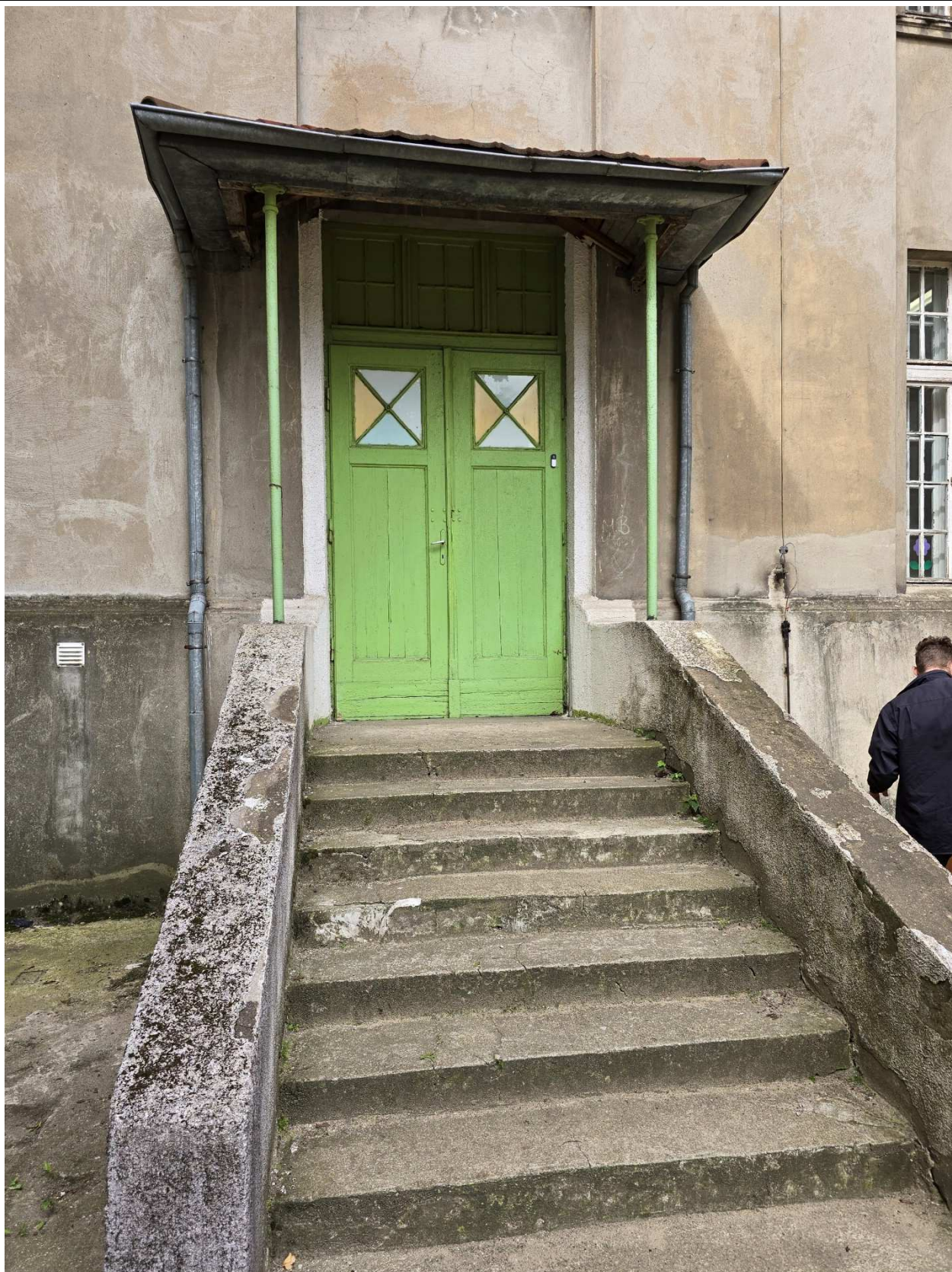
Fot. nr 3 – widok ogólny schodów nr C, schody bez detalu, z ubytkami, odpajającymi tynkami itp.
