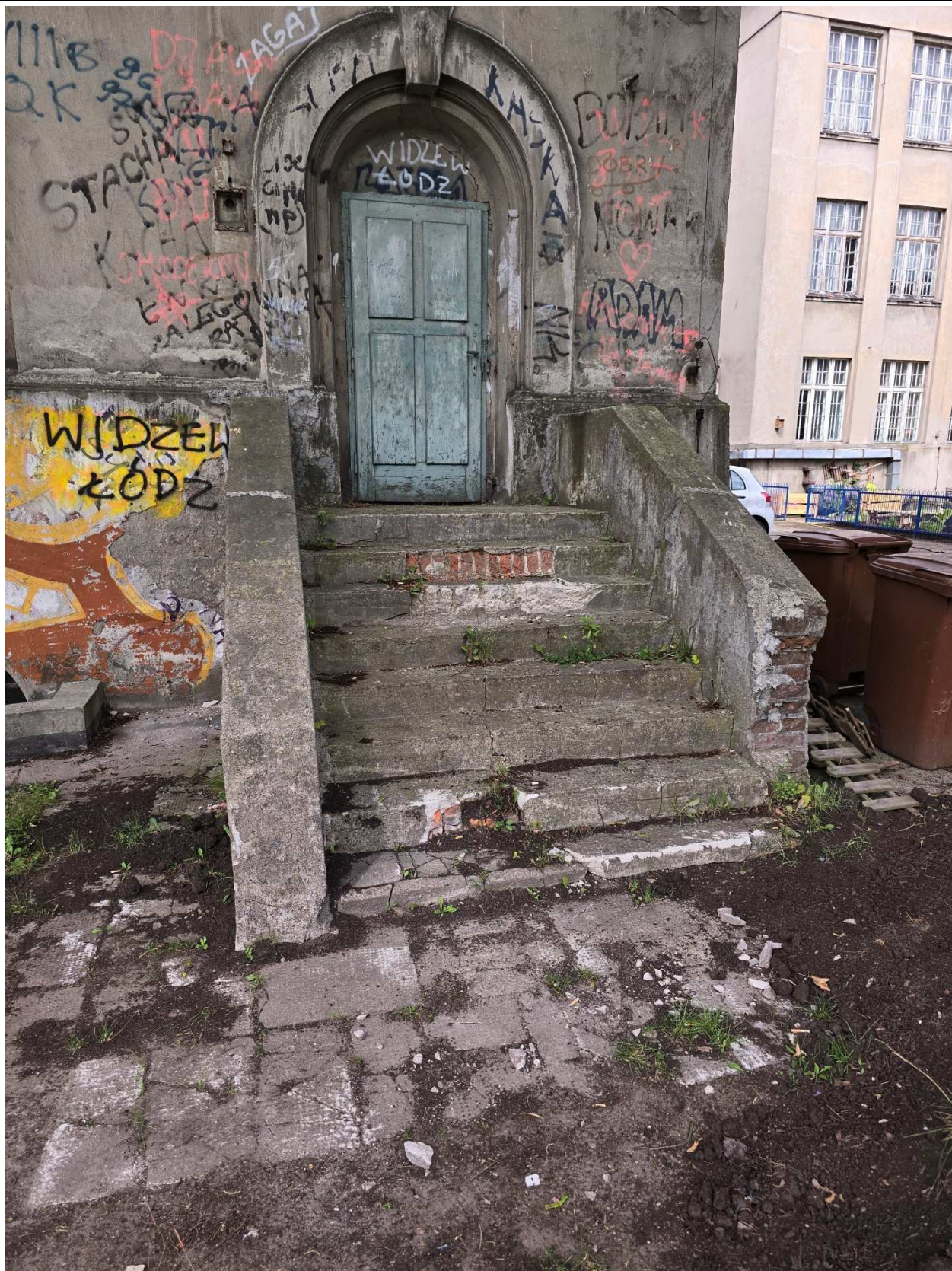
Fot. nr 2 – widok ogólny schodów nr B, liczne ubytki stopni, korozja cegły, spękania itp.
