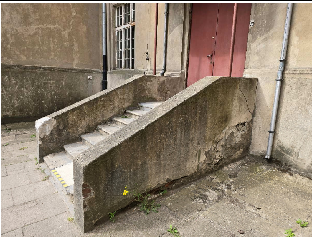
Fot. nr 9 i 10 – widok z boku schodów. Przy schodach nr D widać detal utracony w postaci zamurowanego łuku.
