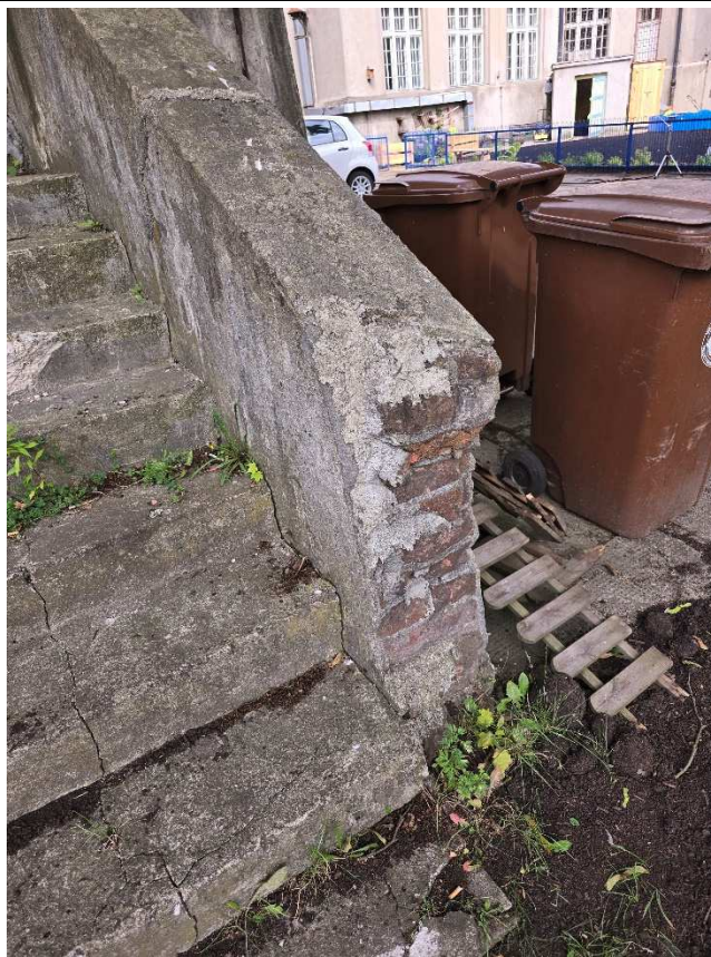
Fot. nr 8 – schody nr B, odspojony kawałek murku
